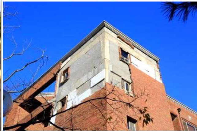
장려(일반) : 조선경 - 한동대 건물 파손
